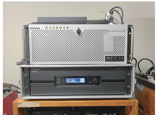
今回大ホールアンプ室に仮設したAFC4とDMET7
